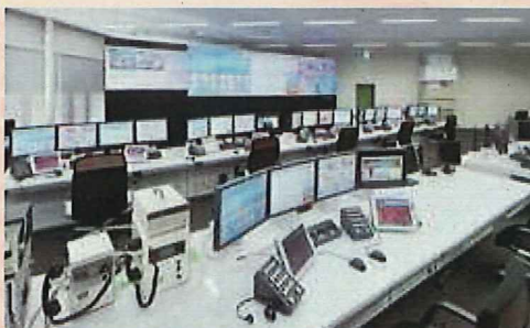
〔消防管制室 全景〕
