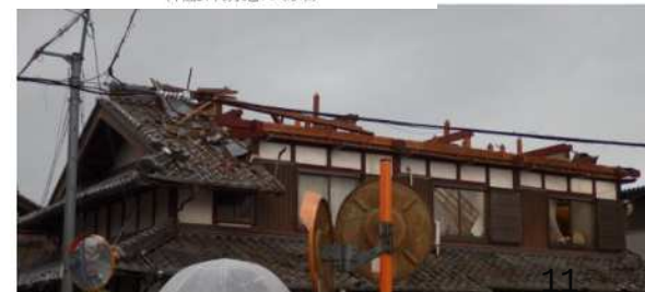
H30年 滋賀県米原市での竜巻による被害
