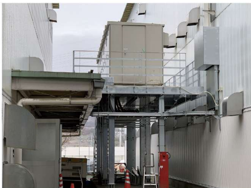
地上3メートルの位置に設置されたキュービクル。電気が通ったことで、工場が再開に向け動き出した
