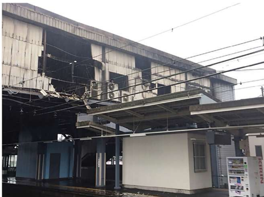
台風21号による全焼直後の尾崎駅 (提供: 南海電気鉄道)
